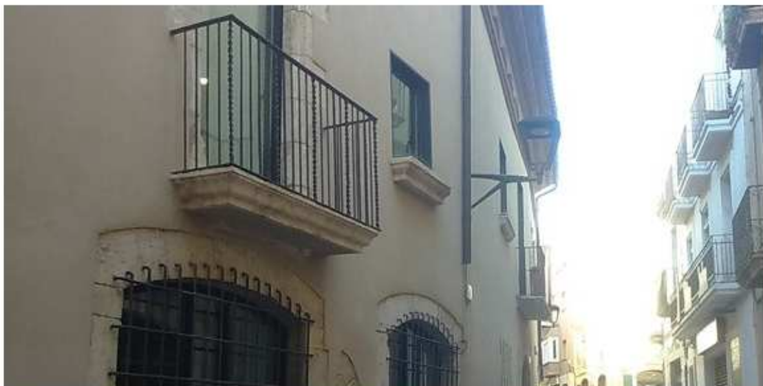
En total són tres les canonades afectades de la Biblioteca. Foto: BP Diari
