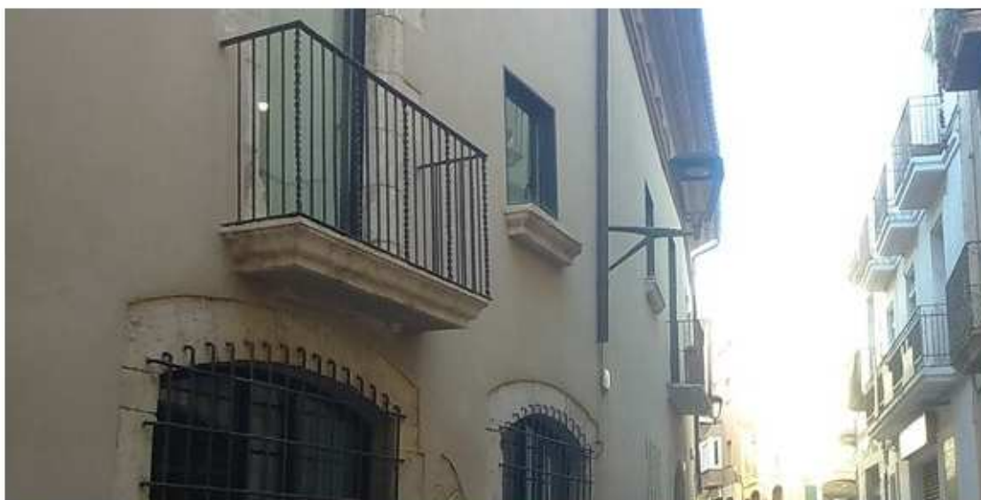
En total són tres les canonades afectades de la Biblioteca. Foto: BP Diari
